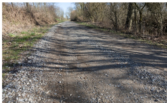
Zustand einer Flurstrasse vor der Sanierung.
