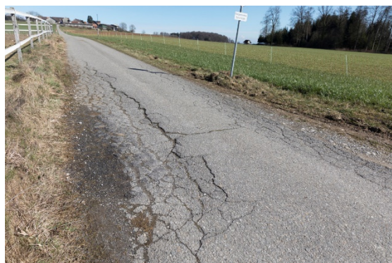
Durch Deformationen und Rissbildung geschädigte Flurstrasse.
